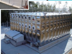
うえがはら 上ヶ原配水池：400 m 3 (左：上ヶ原ポンプ所)
